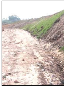
Figura 10- Talude íngreme em função de elevada deformação.
