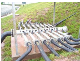
Figura 9- Detalhe do Manifold
