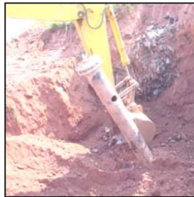
Figura 11- Deformação verificada quando da adaptação do dreno vertical
